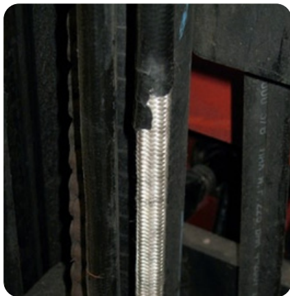
Danno ai tubi flessibili
