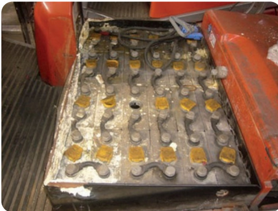
Batteria danneggiata - tappi assenti
