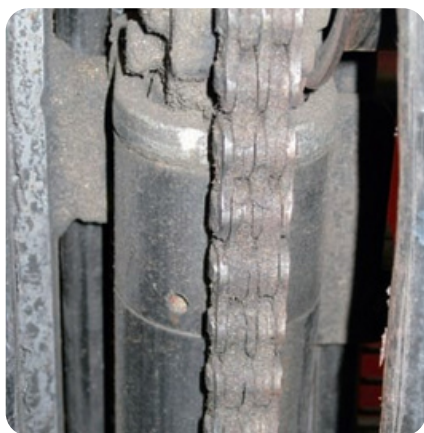
In cattivo stato di manutenzione
